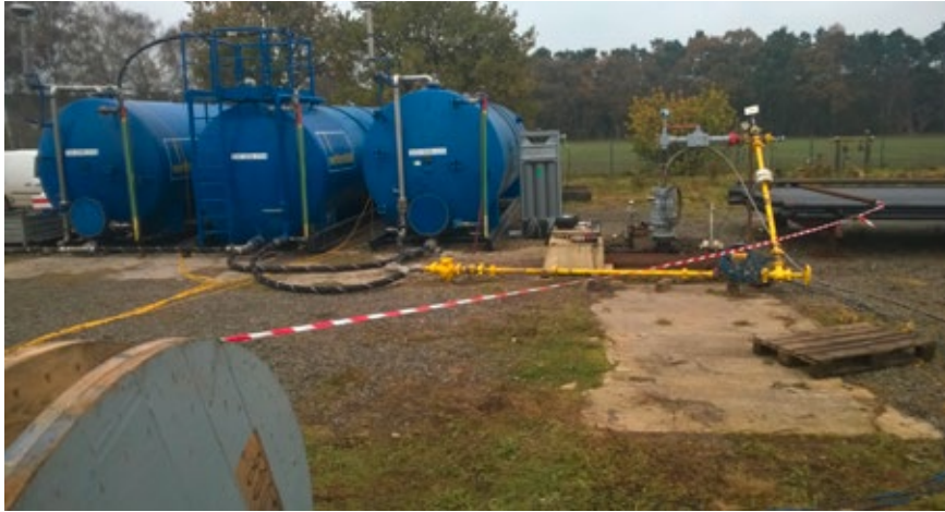
Abb. 12: betriebsbereite Förderanlage mit Absperreinrichtungen und Tankanlage
